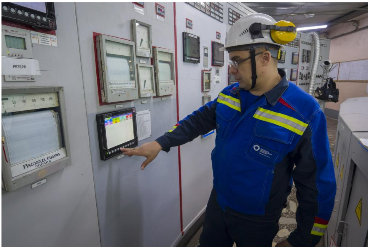
Система автоматизированного управления турбоагрегата Новосибирской ТЭЦ-3. На фото — главный инженер станции Андрей Бабенков
