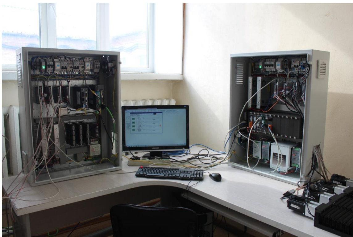
Шкафы с управляющей электроникой и прототип рабочего места оператора для станции 1-3 «Быстропротекающие процессы»
